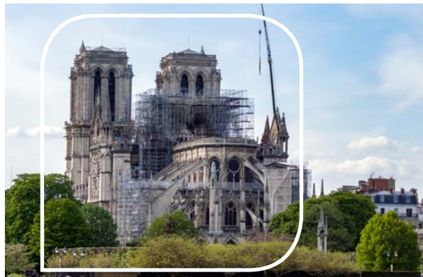
Der Dachstuhl der Kathedrale brannte vollständig ab.
